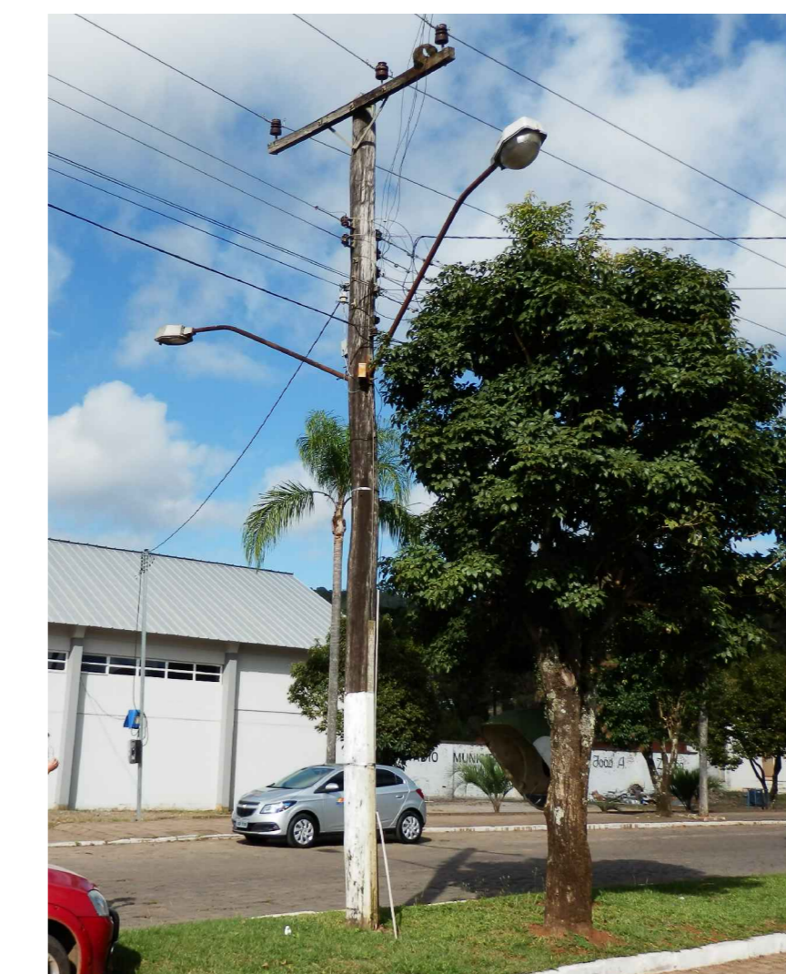
POSTE N.º 02 - EXISTENTE CONFIRMADO DE 10,00 m Medido com trena laser: 7,95 m acima da linha de terra - 0 local foi aterrado.
